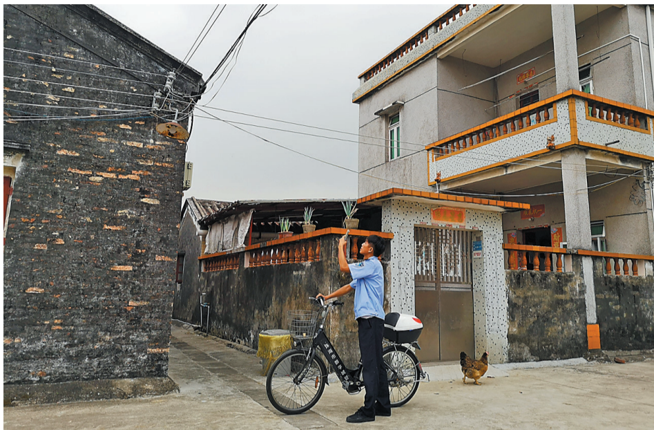
数字城管巡查员朱光华在斗门镇八甲村对破损路灯进行上报。 珠海数字城管供图
