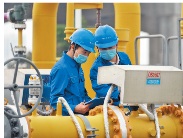
工作人员正在生产作业区对设备进行维保。 本报记者 吴长斌 摄
