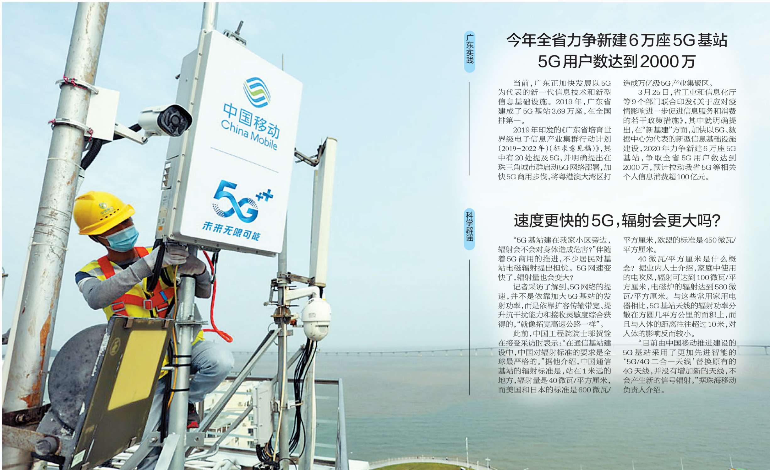
4月10日,技术人员在检查5G基站。中国移动5G基站目前采用更加先进智能的“5G/4G二合一”天线替换原有的4G天线。
