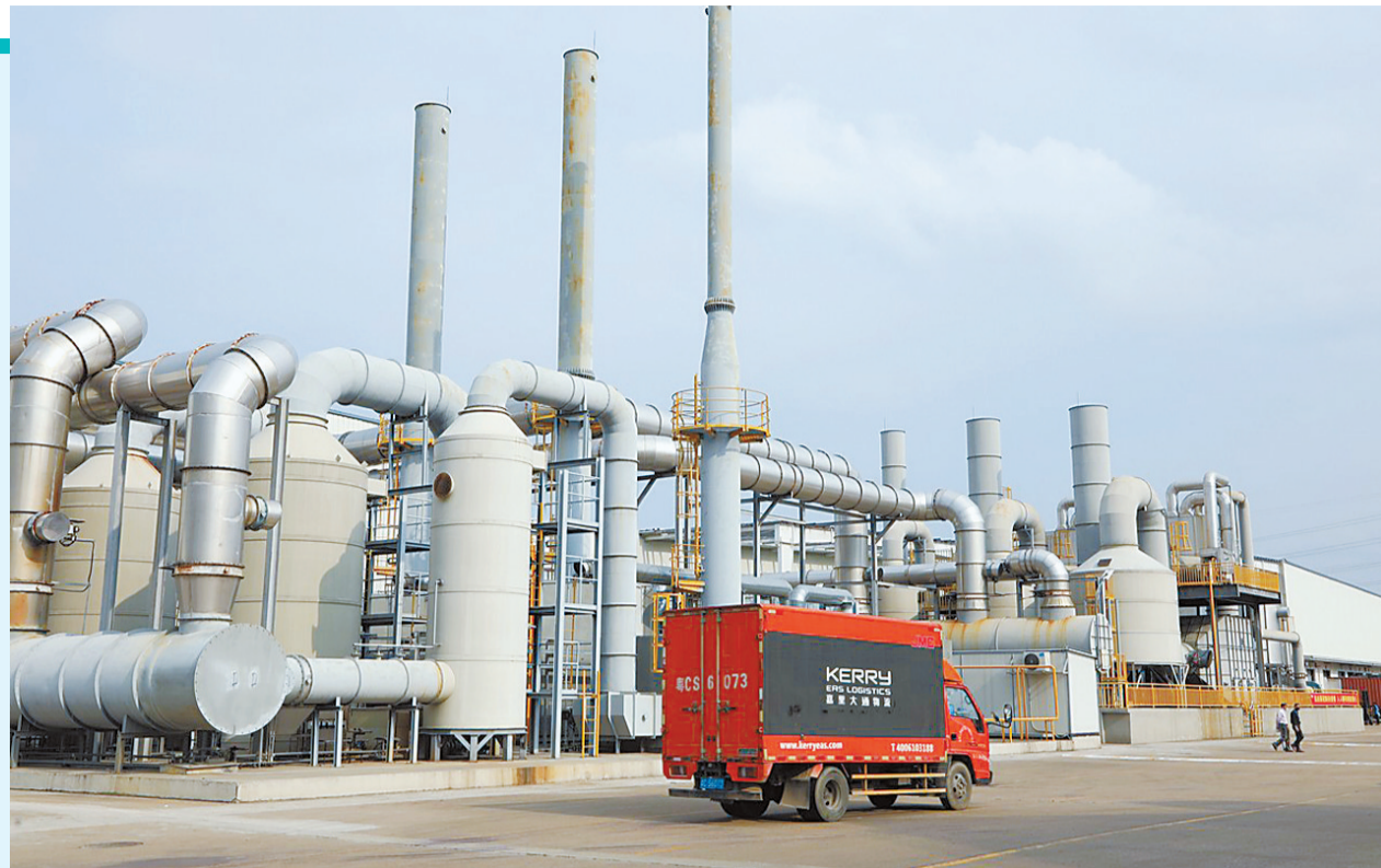
伟创力科技(珠海)有限公司浓缩转轮蓄热式焚烧系统。
