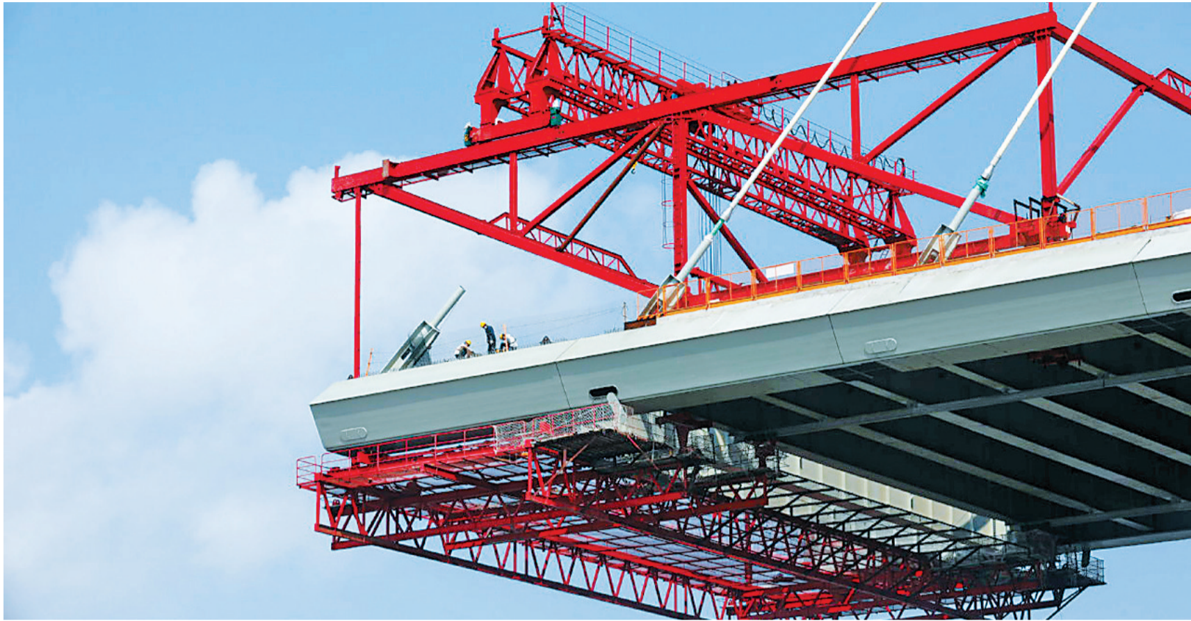
农行珠海分行全力以赴支持珠海重点项目建设,图为洪鹤大桥3号主桥墩施工现场。
