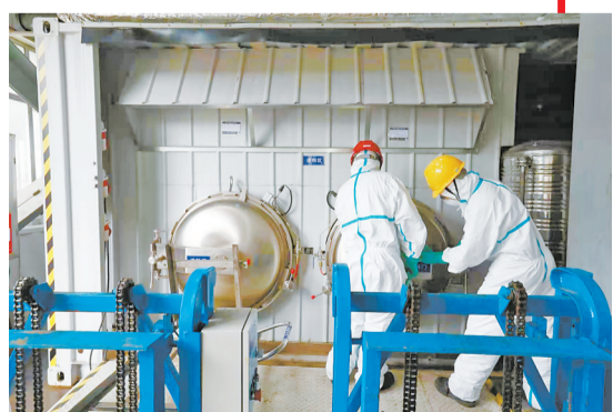
珠海市医疗废物焚烧厂医废处置方舱。
