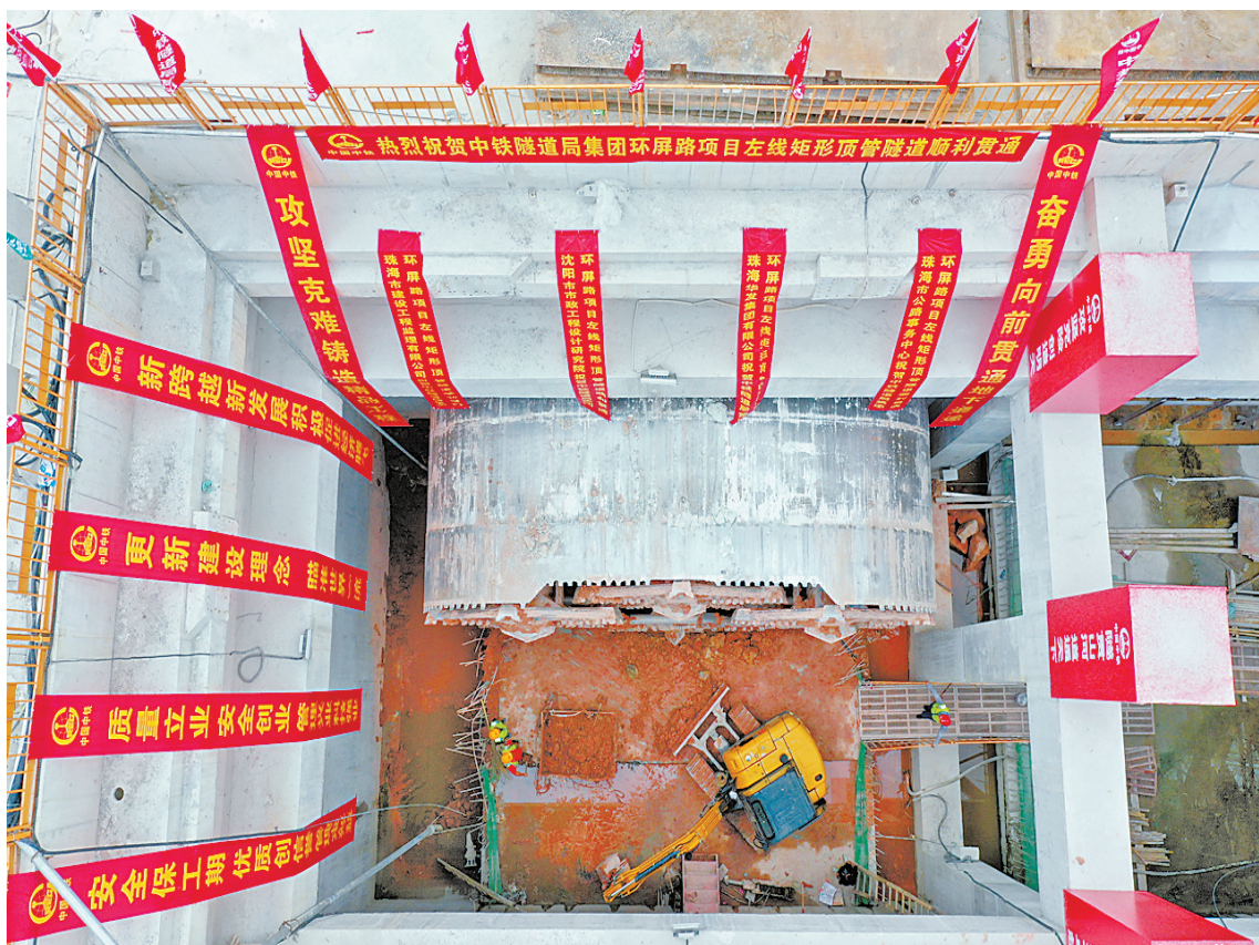
中铁隧道局集团环屏路项目左线矩形顶管隧道顺利贯通。 本报记者 曾遥 摄
