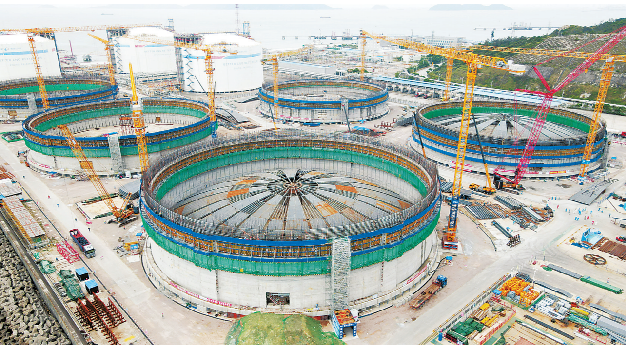
中国海油珠海LNG二期项目施工现场一片繁忙景象。 本报记者 张洲 摄 于广东省珠海市高栏岛,是国家石油天然气基础设施重点工程。该项目于2021年6月开工建设,同时建设5座世界单罐容量最大的27万立方米LNG储罐。项目建成后,珠海LNG接收站年处理能力可达700万吨,将成为我国华南地区规模最大的LNG储运基地,为粤港澳大湾区提供持续稳定的清洁能源。
