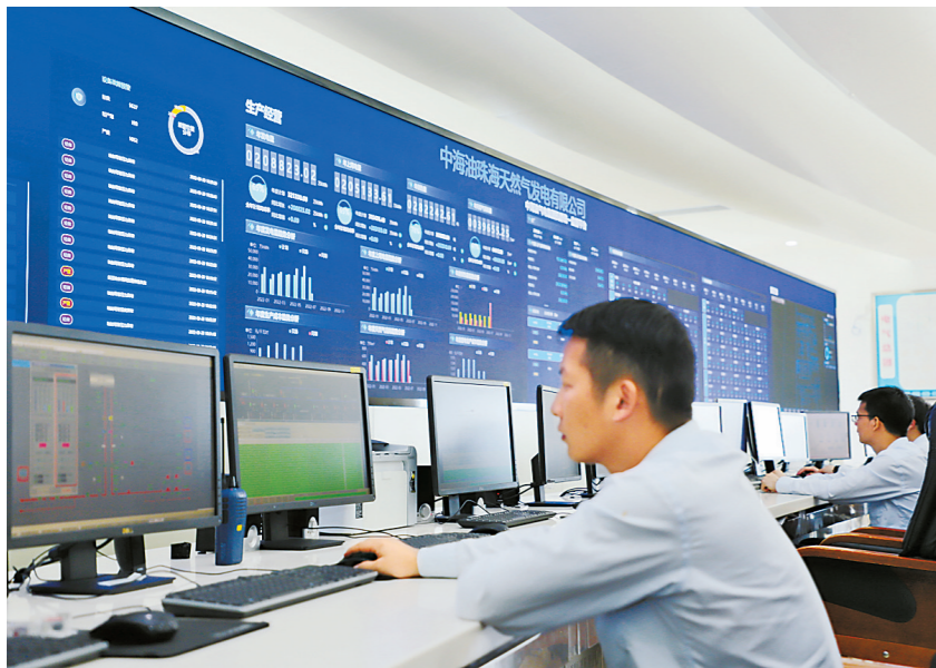
日前,中国海油珠海电厂首次在机组启动过程中应用分布式智能坐席管控系统。 本报记者 张洲 摄
