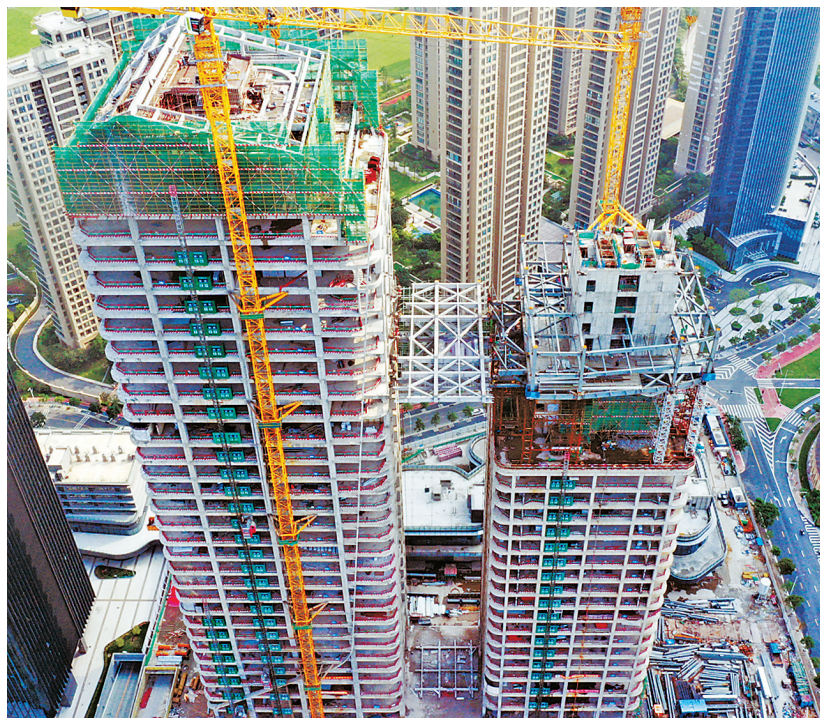
重达350余吨的钢结构连体构件顺利到达设计指定高度103米,成功升顶。本报记者 吴长赋 摄
