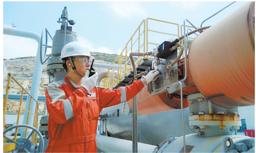
高栏终端工作人员在对管道设备开展巡查工作。 本报记者 张洲 摄
