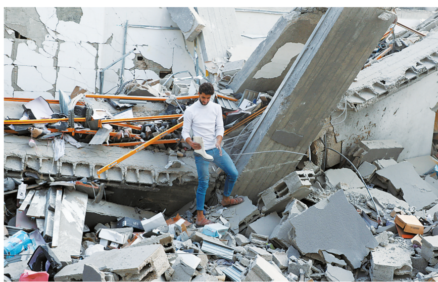
10月8日,在加沙城,巴勒斯坦人查看以色列空袭后的建筑废墟。 新华社发
