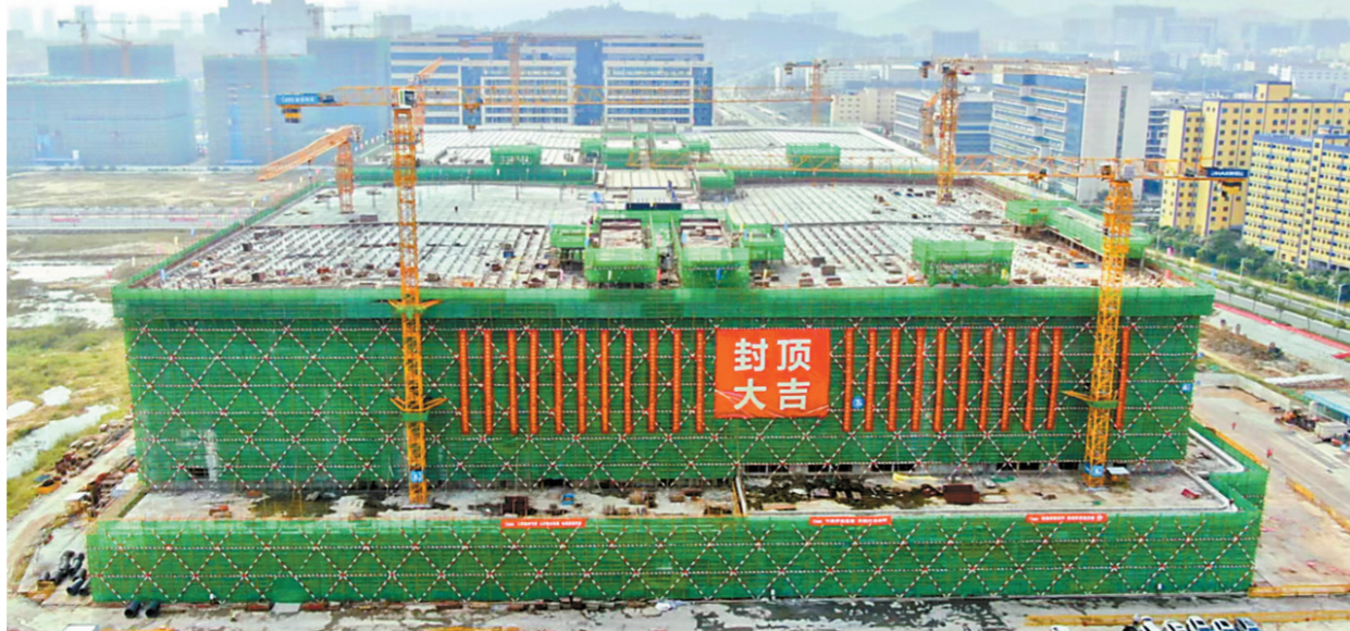
10月15日,迈为技术珠海半导体装备产业园一期厂房主体封顶。
