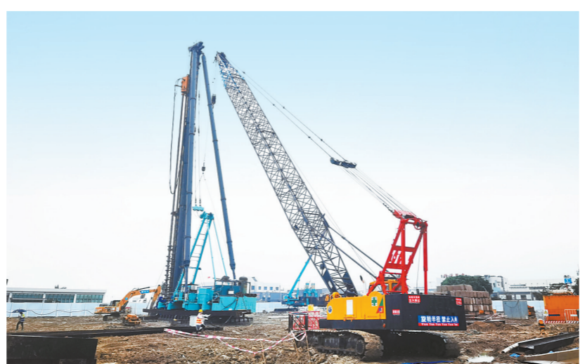
珠海机场新塔台桩基础施工现场。本报记者 张洲 通讯员 谭潇 摄
