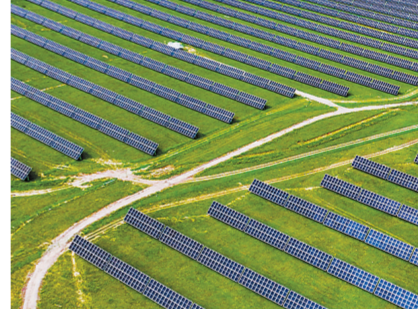
这是8月17日拍摄的内蒙古通辽市霍林郭勒100MW复合光伏项目(无人机照片)。
