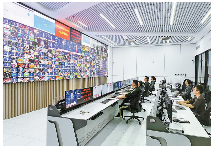
广电网络机房严阵以待,全力保障安全播出。
