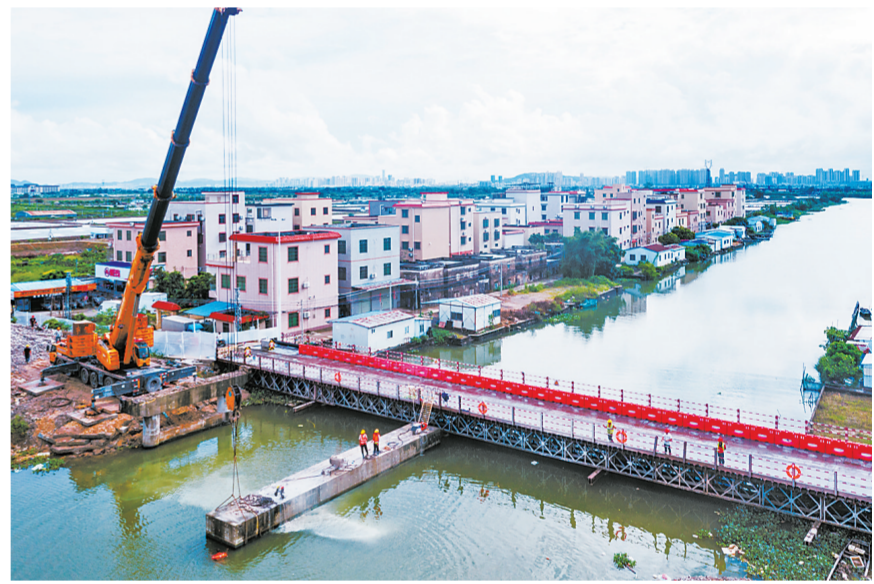
七围桥拆除工作从9月14日开始,采用新的施工工艺,计划国庆前完成拆除施工。本报记者 梁冠贤 摄
