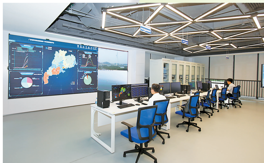
南方电网广东公司横琴供电局可再生能源省地一体化智能调控平台。 本报记者 曾遥 摄
